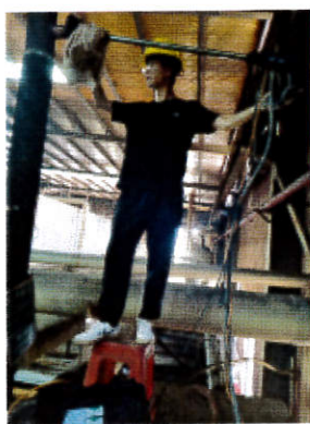
0.3t 柴油锅炉出口
