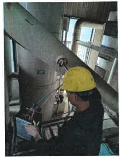
湿法车间无组织废气出口
